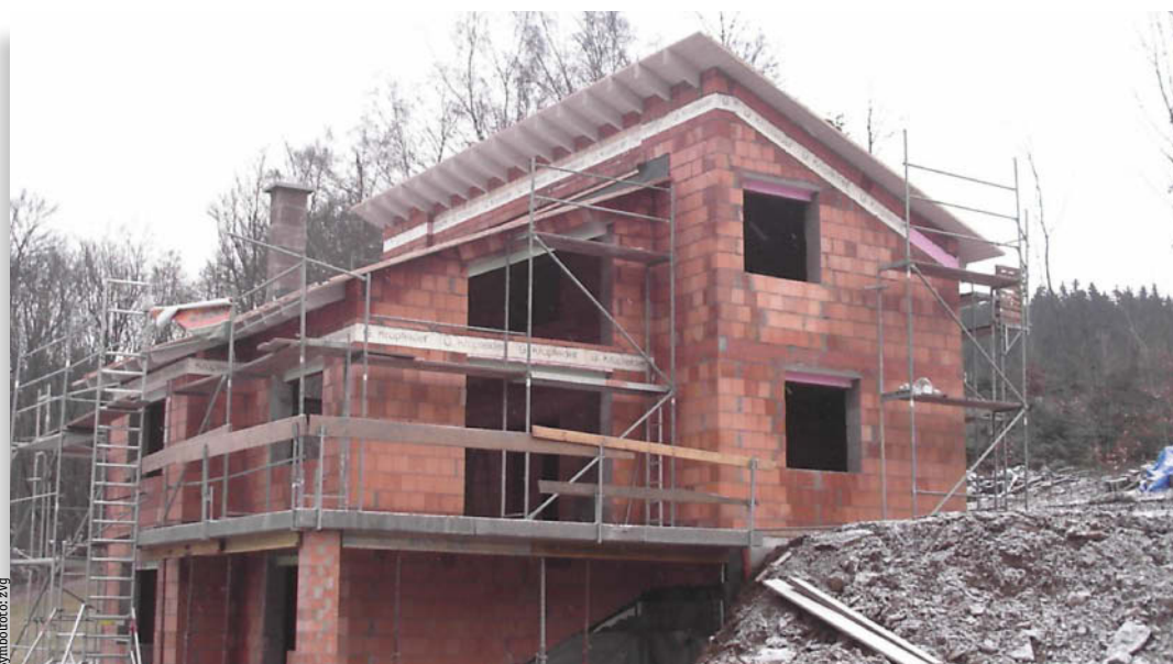
Bei den Bauarbeiten kam es wegen mangelhafter Hangsicherung zu Schäden auf den Liegenschaften der Nachbarn.
