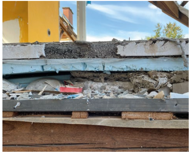
POP-Abfälle (Dämmplatten) im Fußbodenaufbau
