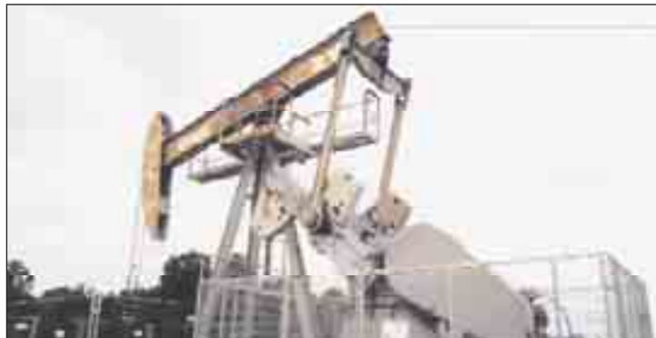
Aktive Pumpenanlage der ÖMV.
