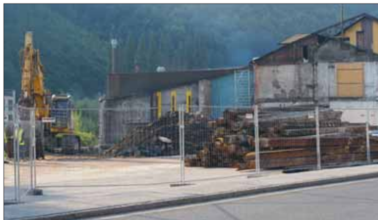
Am Standort der alten Halle in Traisen entsteht ein Neubau, wo auf 800 Quadratmeter Hallenfläche bis zu drei 3D-Sanddrucker betrieben werden sollen.
