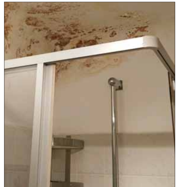
Die Methode der BMB Gebäudehygiene beseitigte auch diesen starken Schimmelbefall nach einem Wasserrohrbruch – eine ideale Bedingung für Schimmelpilze.
