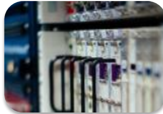
Standortkosten (Platz, Stromverbrauch, Klimatisierung)
