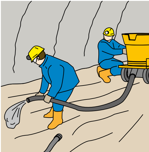
Wartung/Reinigung der Schläuche
