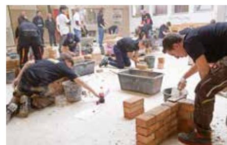
Sowohl beim Berufsschnuppern als auch beim Bau-Lehrlings-Casting wurde jungen Menschen die Faszination des Bauhandwerks nähergebracht.
