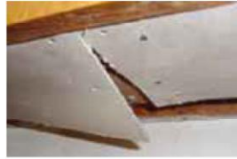
Asbesthaltige Leichtbauplatten (Lüftungen, Schaltschrankauskleidungen)
