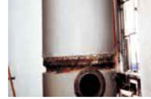
Asbesthaltige Kesselisolierung (abgedeckt)
