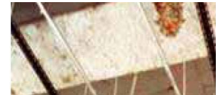
Beschichtung aus Spritzasbest (Brand-schutz)
