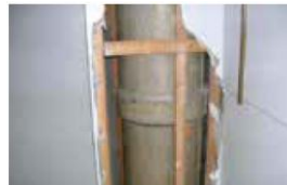
Abfluss- bzw. Abgasrohre aus Asbestzement
