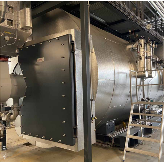
Kessel bald mit Bioethanol statt Erdgas
