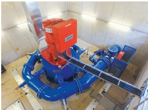
Pelton Turbine HPP Hintergössgraben
