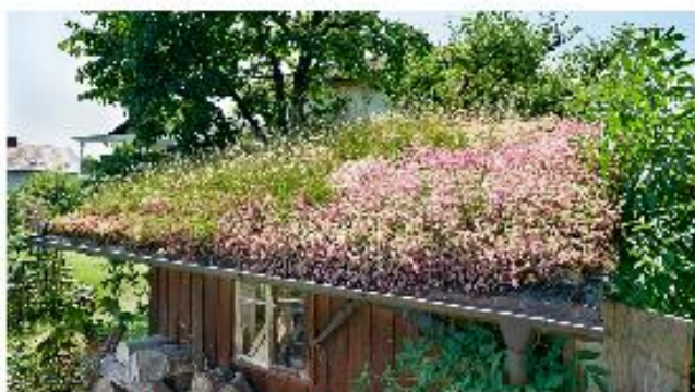
Begrünte Dächer binden Staub und sind ein perfekter Abwasserspeicher Foto: COVIBIT
