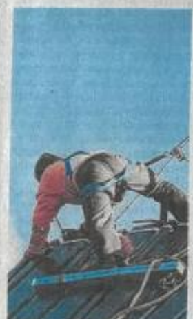
Ist kein Gerüst vorhanden, dürfen Jugendliche nicht aufs Dach.
