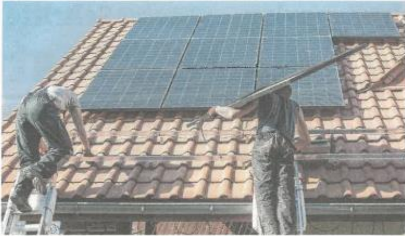
PV am Dach n den Profis erspart unliebs Überraschung © wjanek | stock.adobe.com
