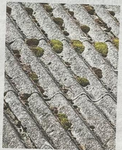
In die Jahre gekommene Eternit-Dacheindeckung Foto: JGade/stock.adobe.com
