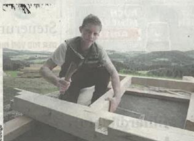
Zimmerer und Zimmereitechniker sind Profis für Holzkonstruktionen aller Art. Diese Lehrberufe bieten Burschen und Mädchen sehr gute Chancen am Arbeitsmarkt. Foto: WKÖÖ
