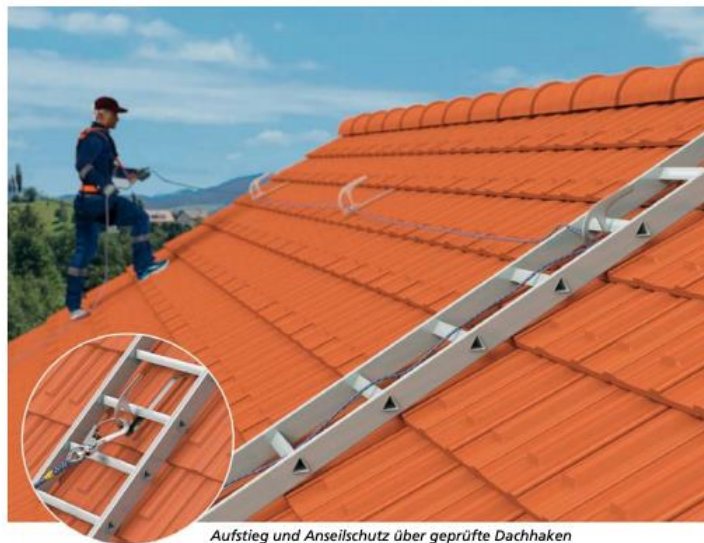
Aufstieg und Anseilschutz über geprüfte Dachhaken
