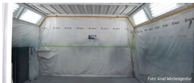
Blick in die moderne Lackierkabine im MobilitätsCampus.
