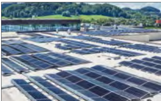
Photovoltaik-Anlage auf dem Dach von Sony DADC in Thalgau.
