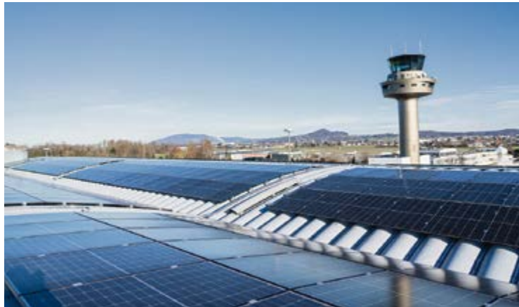
Eine neue Photovoltaik-Anlage wurde auf dem Dach des Parkhauses errichtet. Mitte Dezember startete der Probebetrieb. © Flughafen Salzburg
