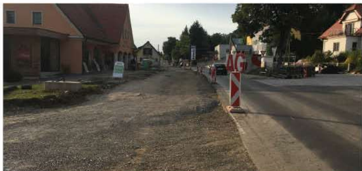
Langzeitbaustelle: Stadtauswärts ist die St.-Peter-Hauptstraße gesperrt. Die Bauarbeiten werden noch bis Dezember dauern. KK
