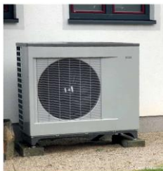
Abbildung: Wärmepumpe im Freibereich
