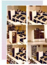
Rechenanlage in der KSV1870 Zentrale
