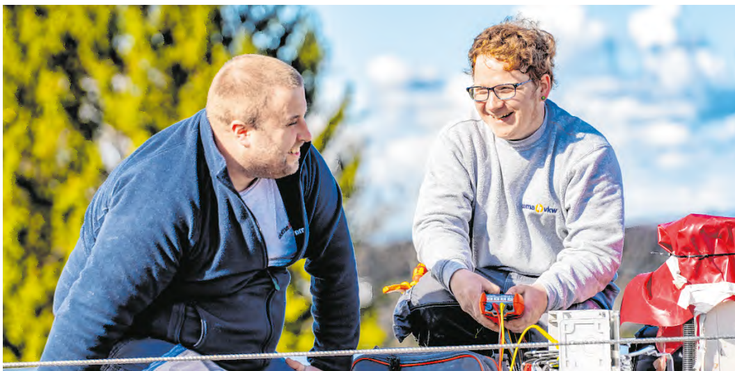
Mit Photovoltaikanlagen können Unternehmen einen Teil ihres Strombedarfs selbst produzieren. © doma vkw
