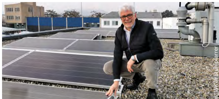
Roland Kuras ist einer der Vorstände der „Grätzl Energie“. Deren erste Photovoltaik-Anlage wurde auf dem Dach von dem Betrieb W. A. Richter's Söhne GmbH in der Perfektastraße errichtet.
